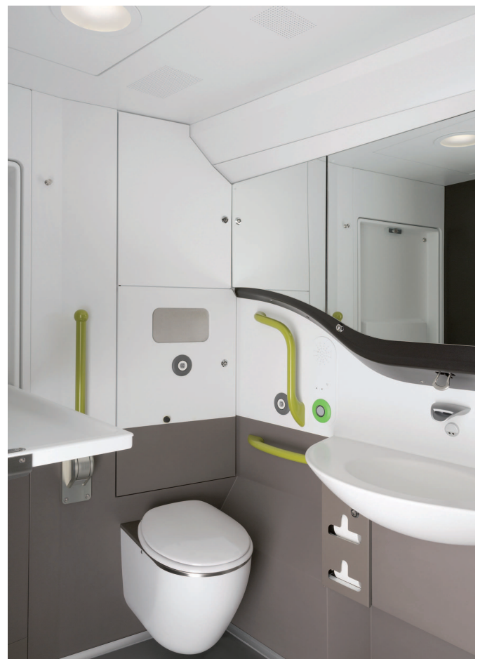
Bild 2 Nicht nur das Design, sondern auch die zu beachtenden Vorschriften für die Kabinen weichen von Land zu Land voneinander ab. Die damit verbundene Variantenvielfalt wird von „SmartAssembly“ unterstützt.
